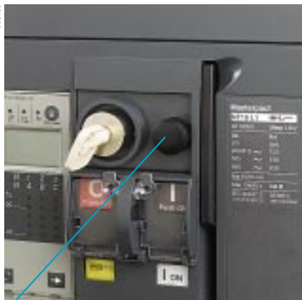
Кнопка электрического включения (BPFE)
