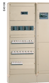
Силовой распределительный щит с вводным выключателем-разъединителем Interpact на токи 400 – 2500 А
