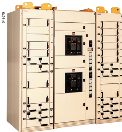
049575 Главный силовой распределительный щит Masterbloc с выключателями-разъединителями Masterpact
